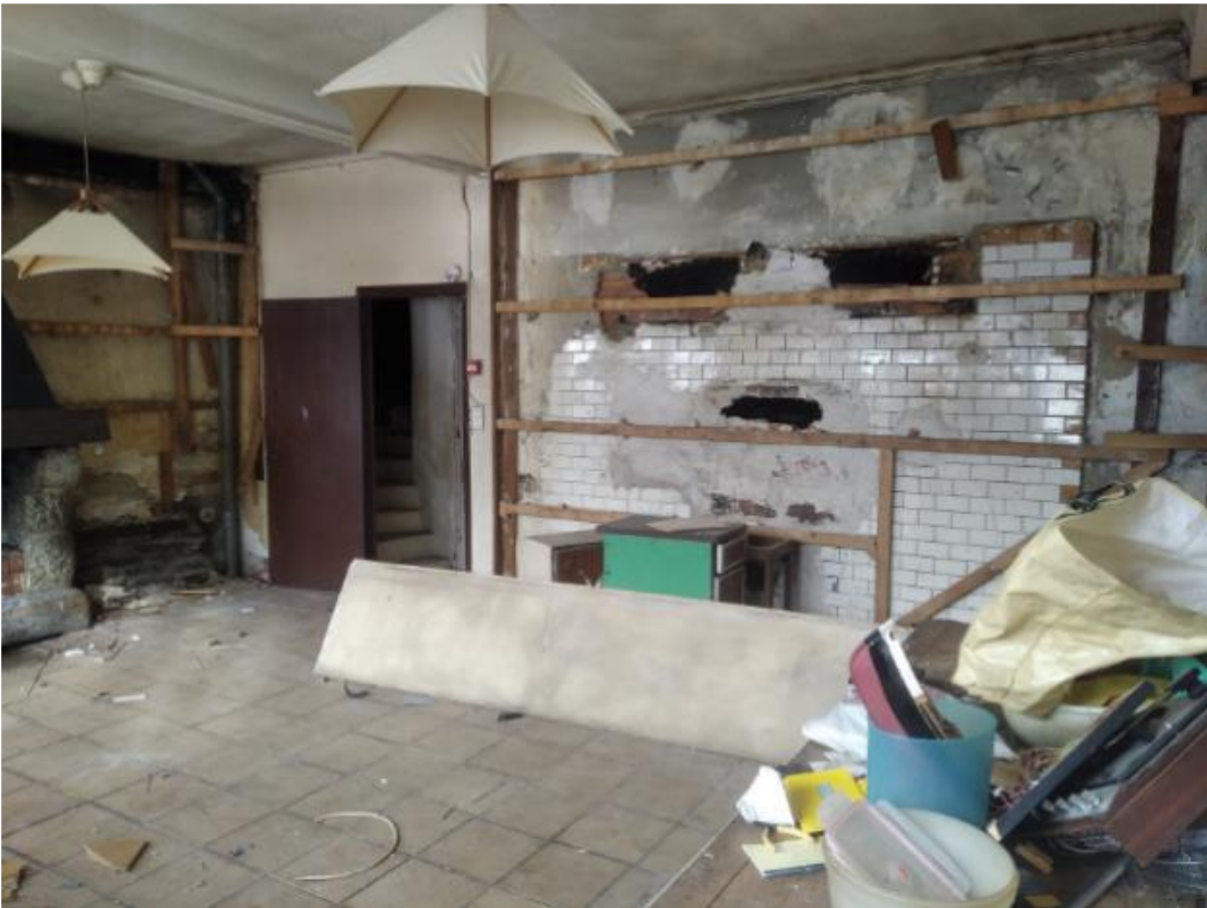
Appartement du bas : four à pain à détruire
